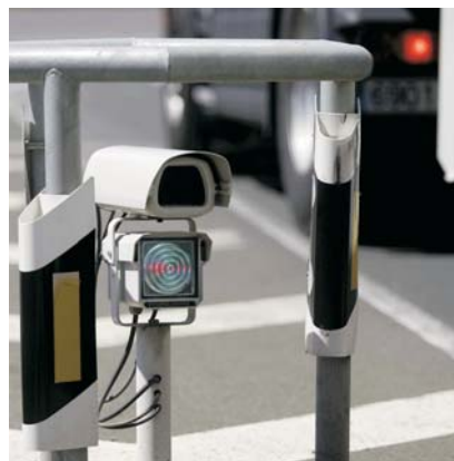
Control d'accés de vehicles
